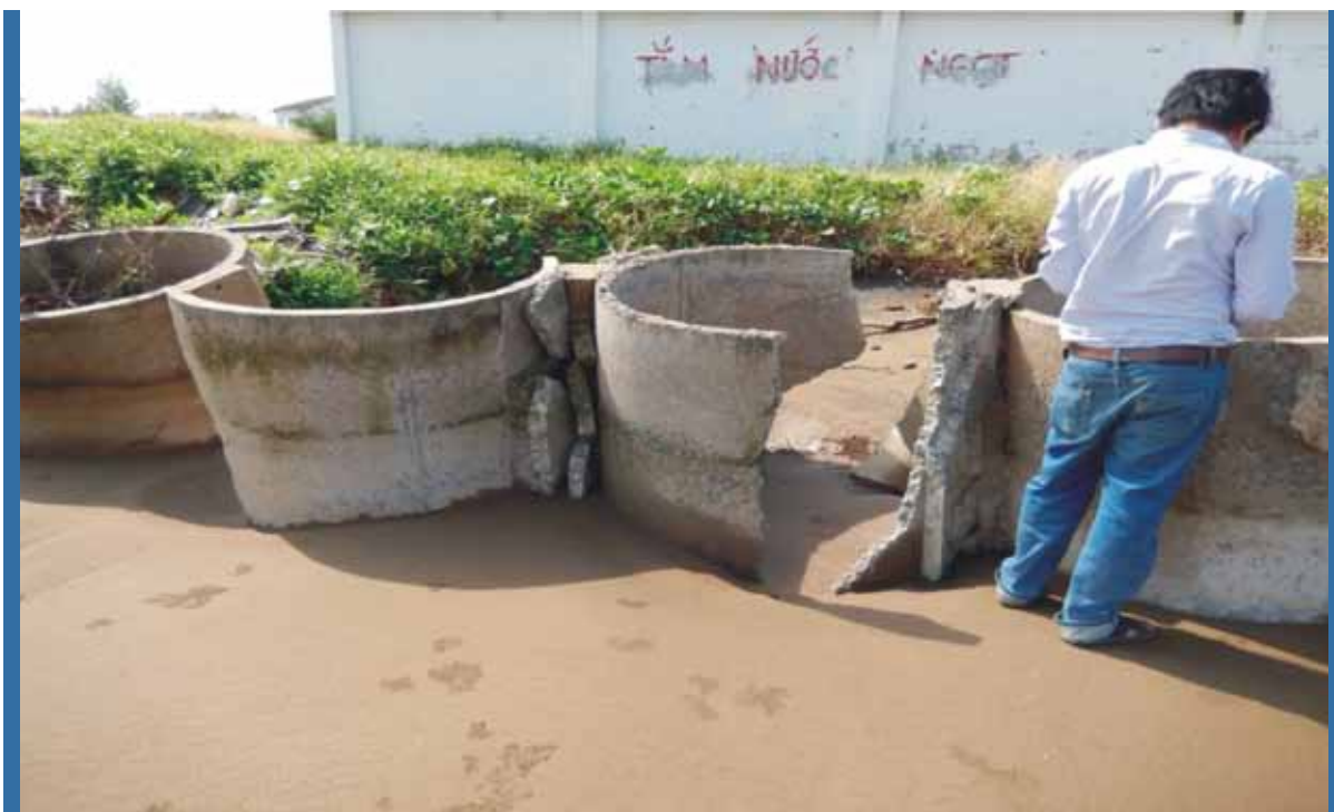
Hình 23: Biện pháp chống xói mòn bị hư hỏng tại địa điểm 3, phần phía đông
